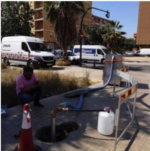
Instalación – Punto de extracción.
